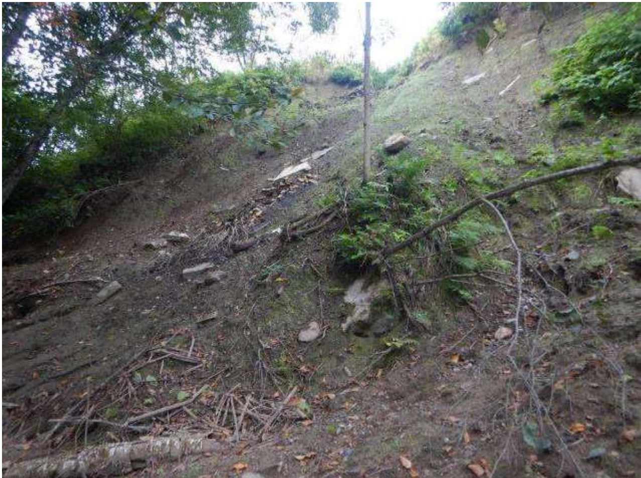
Figure 4 : Vue du glissement de terrain à partir de la base du talus.
