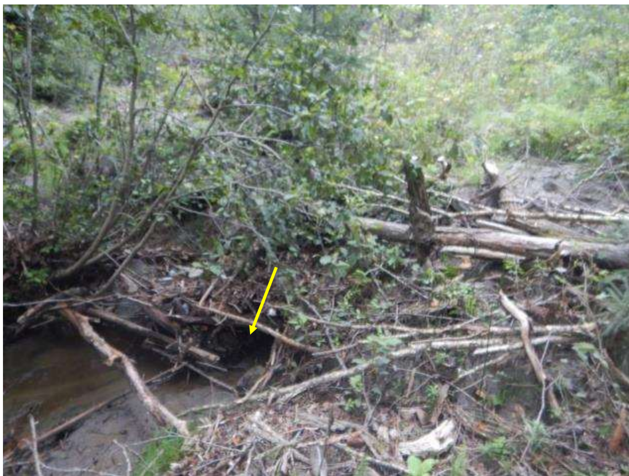
Figure 5 : Entrée du ponceau (flèche jaune) obstruée par les branches et débris divers (29 août 2023).
