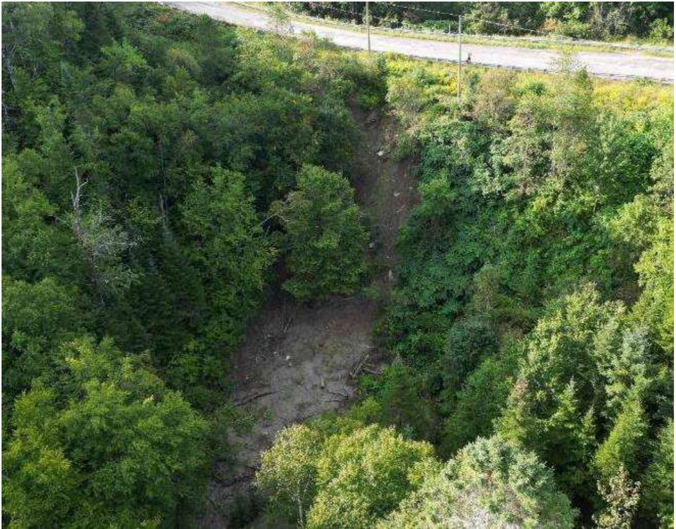
Figure 3 : Vue d'ensemble du glissement survenu sur le versant amont du remblai du chemin de la Batiscan. Photographie prise lors d'un survol en drone le 29 août 2023.
