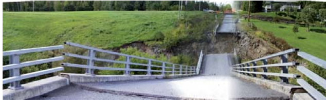
Figure 4.1 Photographie du glissement qui affecta le pont de la route Bourchemin qui enjambe la rivière Salvail près de son embouchure.
