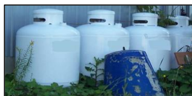
Non-conformité : Mauvaise installation avec blocs de béton non conforme et présence de mauvaises herbes
