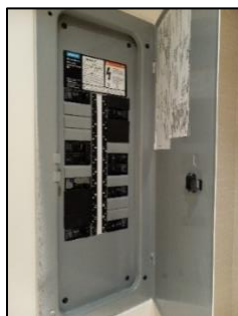
Panneau de distribution
