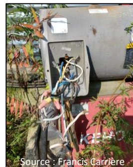
Non-conformité (raison : filage extérieur non protégé)
