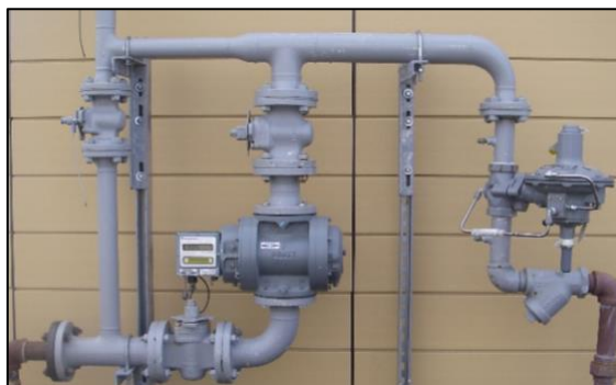
Entrée de gaz naturel
