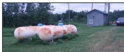
Non-conformité : Absence de protection mécanique à proximité d'une voie carrossable
