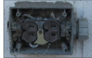
Non-conformité : Aucune protection
