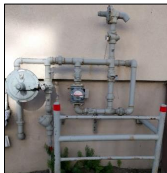
Entrée de gaz naturel avec une protection contre les impacts
