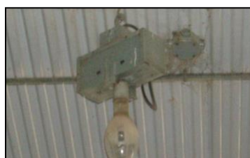
Non-conformité : Aucune protection
