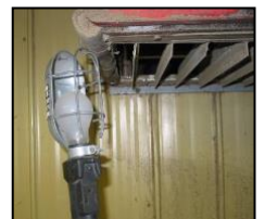
Non-conformité : La lampe incandescente est non protégée.
