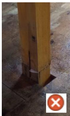
Photo 4 - blocage absent et connexion non conforme1
