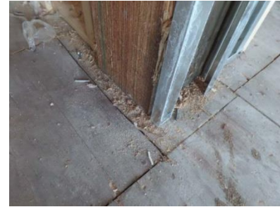
Photo 3 - raccords non conformes
