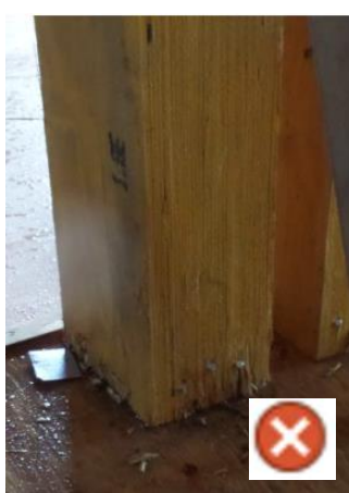
Photo 5 - connexion non conforme
