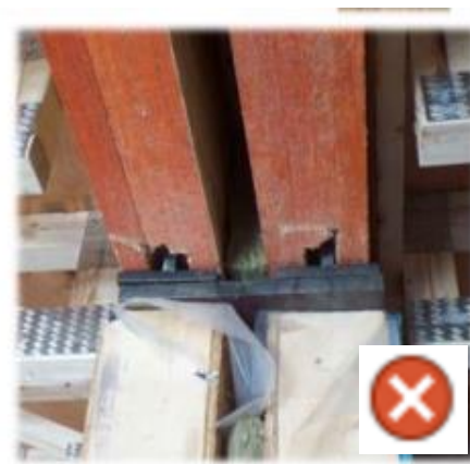
Photo 8 – rainure non conforme pour plaque en T
