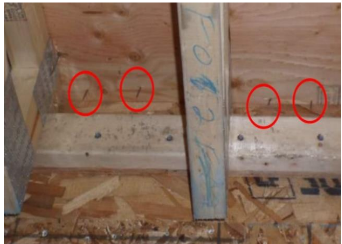
Photo 5 – clous verticaux qui manquent la poutre de rive
