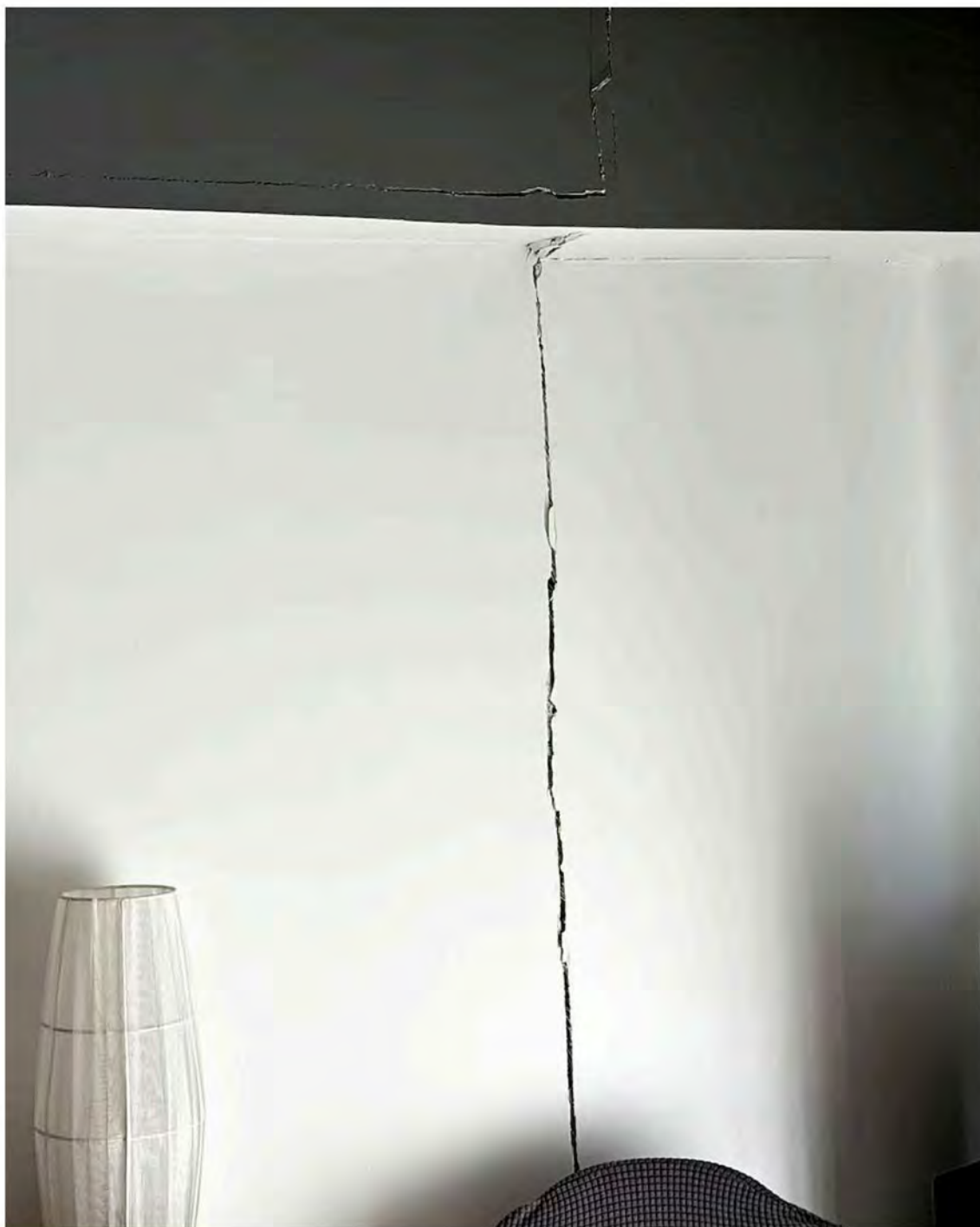
Le mur de la chambre de Mme Lamontagne est complètement éventré. COURTOISIE JOSÉE LAMONTAGNE
