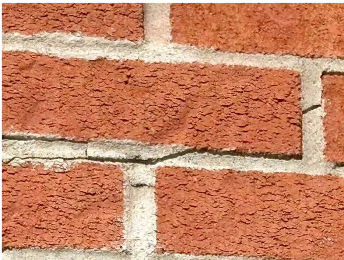
Des dommages sont visibles sur la façade extérieure de l'immeuble. COURTOISIE JOSÉE LAMONTAGNE
