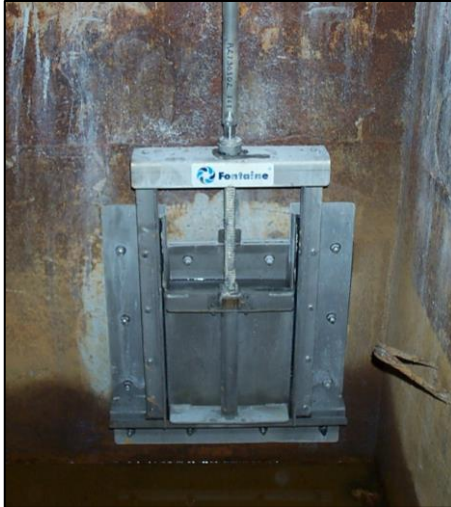
Figure 5-5. Exemple de vanne murale avec trop-plein de type déversoir
