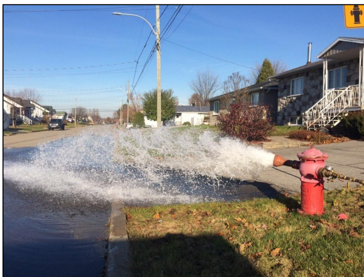
Figure 9-11. Exemple d'une opération de rinçage d'aqueduc. S'il est mal planifié (p. ex., ouverture de plusieurs poteaux d'incendie en même temps, rinçage réalisé en contexte de pluie ou en période de pointe de rejet d'eaux usées), le rinçage peut provoquer des débordements.
