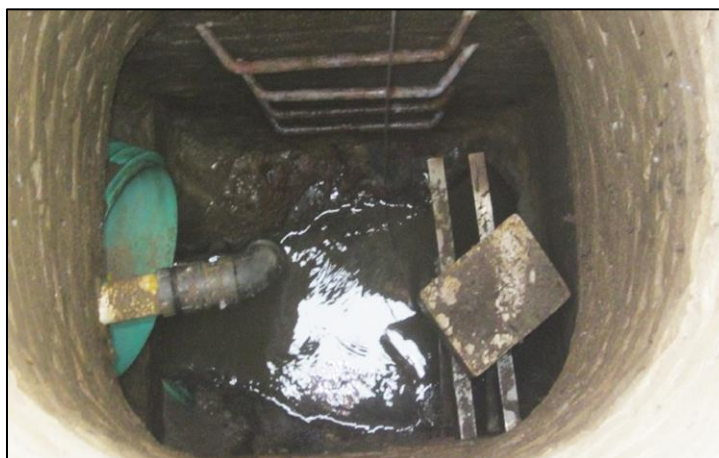
Figure 9-29. Exemple de problème d'exploitation d'une municipalité du Québec. Un repère visuel (carré de styromousse blanc) de grandes dimensions a été installé pour suivre les débordements dans la conduite de trop-plein, mais il s'est déplacé dans la conduite d'égout principale et l'a ainsi obstruée. Cette situation a généré un débordement continu pendant une semaine avant qu'il ne soit détecté par la municipalité.
