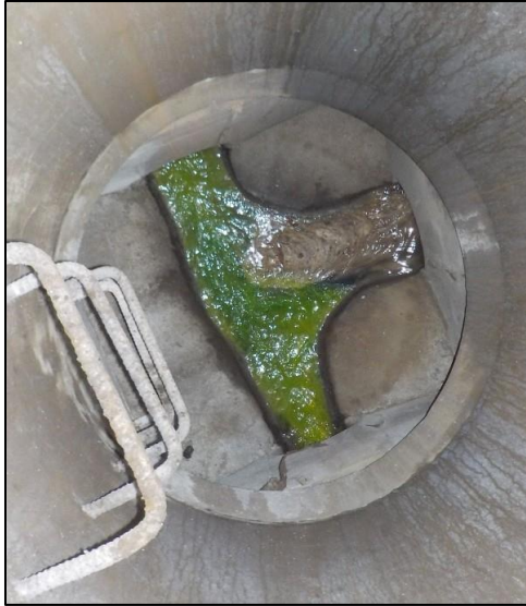
Figure 11-7. Exemple d'utilisation d'un colorant vert pour détecter dans un regard d'un système de gestion d'eaux pluviales la présence d'un raccordement inversé
