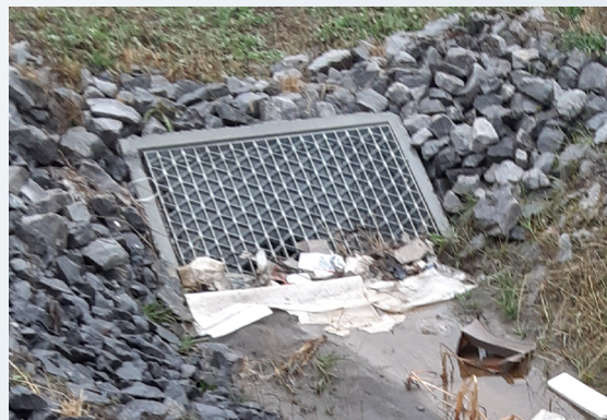
Avaloir pour séparer les eaux de fossé de rue d'un passage faunique de la rainette © Lyne Bouthillier
