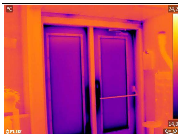
T-110: ( \Delta P -) Infiltration d'air par l'assemblage de la porte ainsi qu'au périmètre du cadre. Certains refroidissements sont attribuables à des pertes thermiques par conduction;
