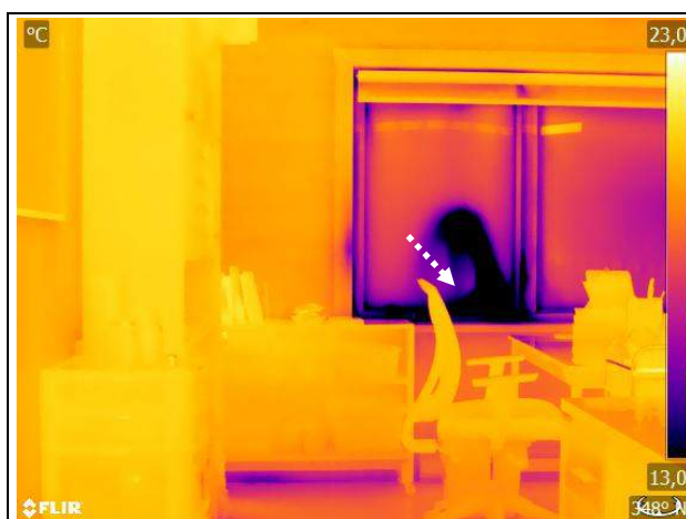
T-104: ( \Delta P -) Infiltration d'air par la fenêtre (fermeture et ajustement du volet en cause)
