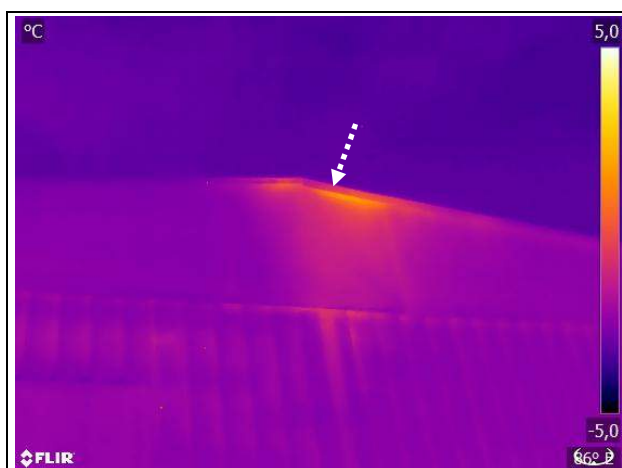
T-9: ( \Delta P+ ) Réchauffements ponctuels à proximité du faite de toit indiquant un manque d'étanchéité à l'air ponctuel au joint d'assemblage de modules préfabriqué
