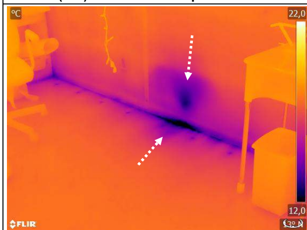
T-75: ( \Delta P -) Infiltration d'air à la base du mur
