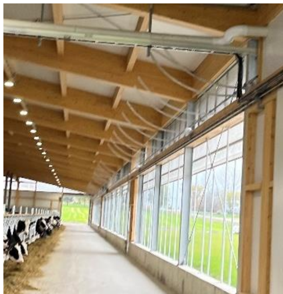
Figure 4 – Ouverture de ventilation
