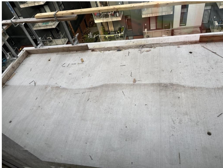
Figure 19 – Trous apparents dans la dalle de balcon préfabriquée
