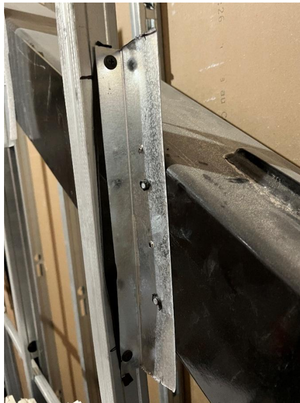
Figure 15 : Coussin insonorisant installé au point d'ancrage entre le montant de la cloison de gypse mitoyenne et le contreventement en acier
