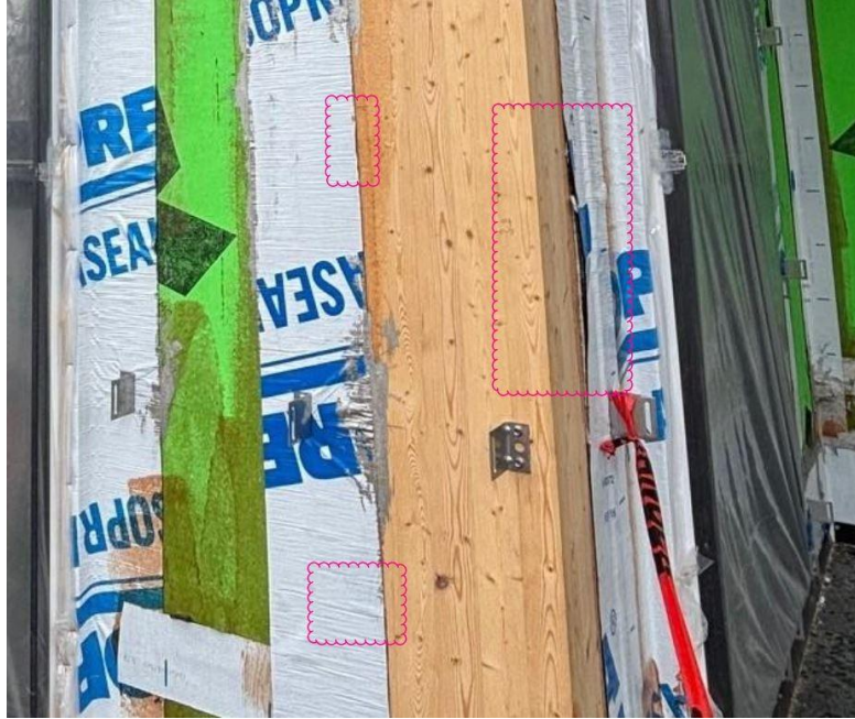
Figure 22 – Bandes de membranes adhérant mal au bois. Il a finalement été décidé de recouvrir l'entièreté des colonnes de bois d'une membrane, de manière à assurer leur pleine adhérence avant l'application de l'uréthane.
