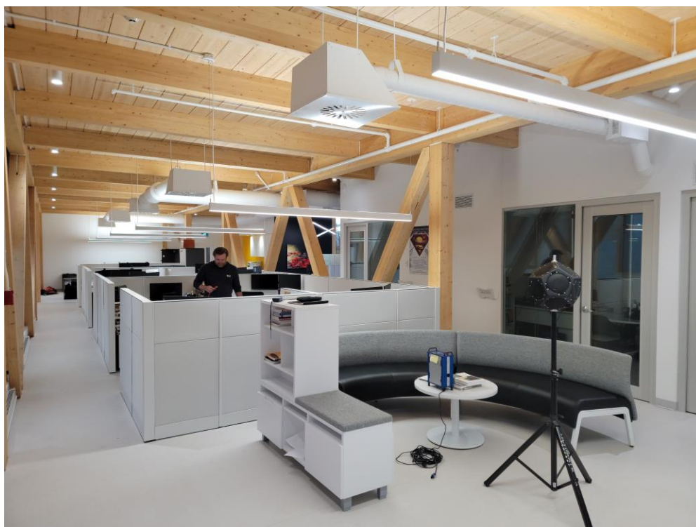
Photo 4 : Source de bruit au-dessus de l'espace Qscale.
